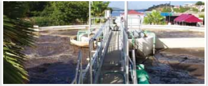
Planta construida en campo para flujos de hasta 1,000,000 GPD
